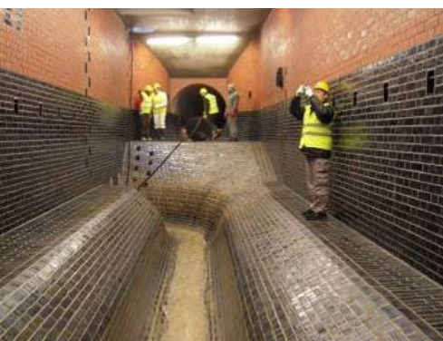
Obr. 4 Splaškový průtok v komoře
